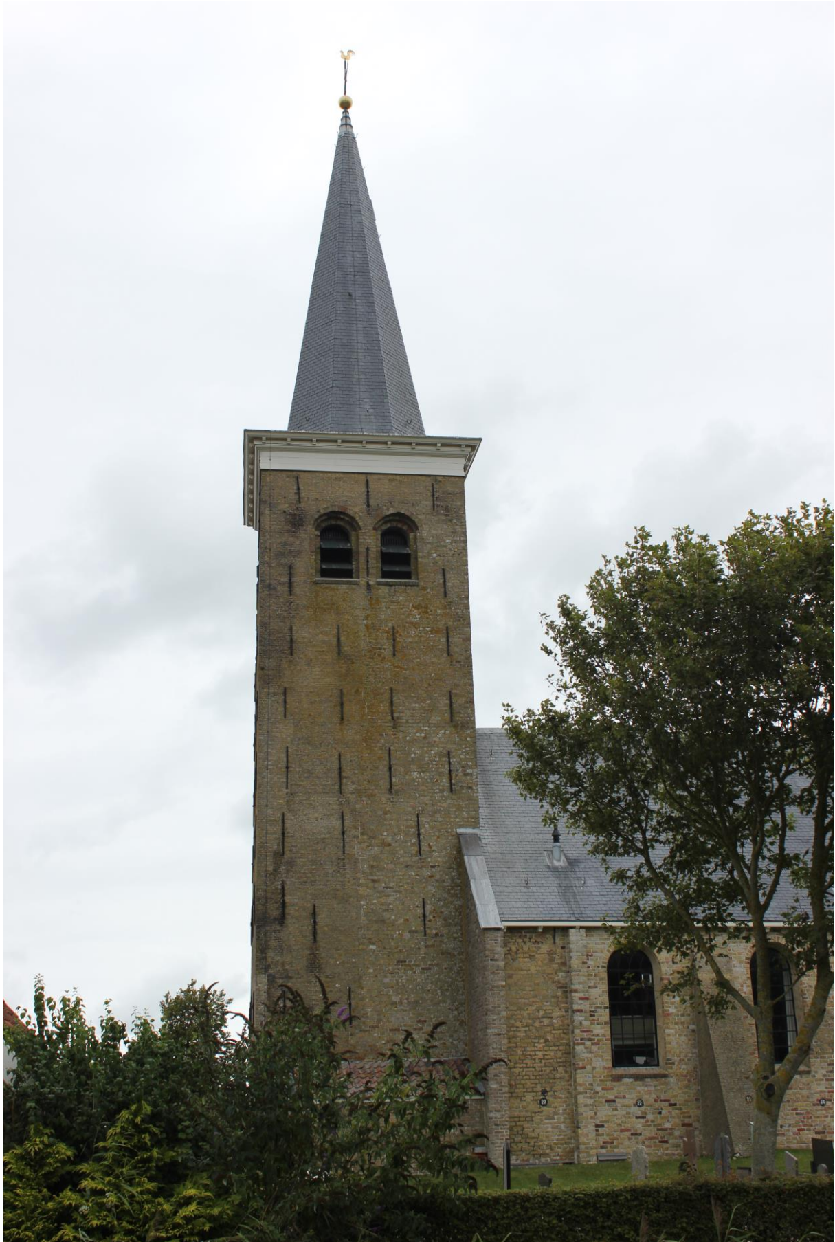
Foto 2. De zuidgevel van de kerktoren. Opvallend is het groot aantal ankers.
