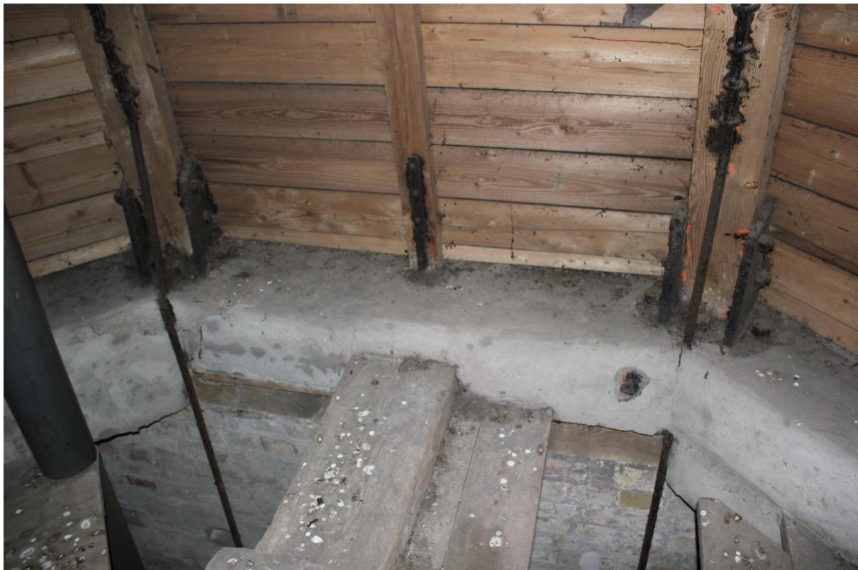
Foto 31. Het tafelfment van boven, uit de voet van de torenspits gezien. Beton en de ijzeren schoenankers dateren uit 1926. De draadankers zijn door de ringbalken gemonteerd en aan de hoekkepers van de spits bevestigd.
