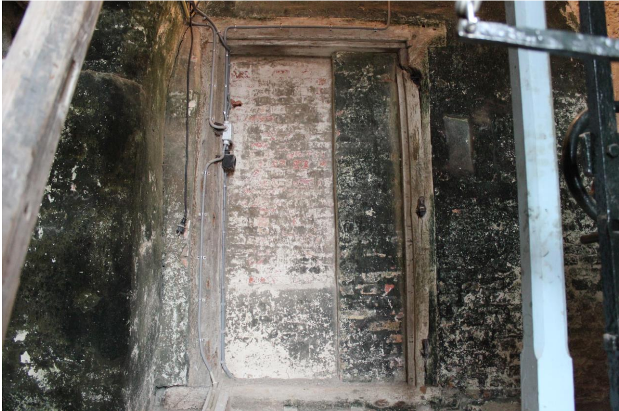
Foto 11 . Het kozijn van de doorgang naar de orgelgalerij. Opvallend is de manier van dichtmetselen. Links is het metselwerk tegen de achterzijde van het kozijn gezet terwijl het rechterdeel in het kozijn is gemaakt.
