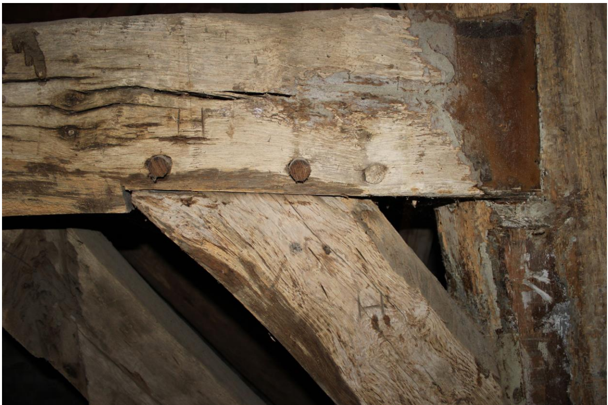
Foto 29. De gehakte letter H in een van de dekbalken en in het korbeel. Hier duidelijk behoud gaat voor vernieuwen. Epoxyherstel heeft ertoe bijgedragen dat de dekbalk en korbeel inclusief merktekens zijn behouden.
