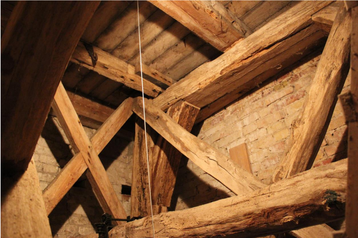
Foto 17. Een bovenste deel van de klokkenstoel op de derde verdieping. Zichtbaar is het andreaskruis tegen het staanderstel. Op de voorgrond is een rondhouten trekbalk aanwezig.
